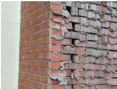
Foto 7: Lücken im Mauerwerk als Beispiel für potenziell nutzbare Zwischenräume für gebäudebrütende Vogelarten und für Fledermäuse (eigene Aufnahme 18.04.2023)
