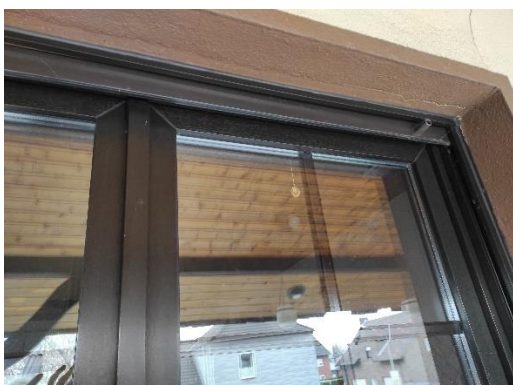
Geschlossenes Fenster mit Rollladenkasten
